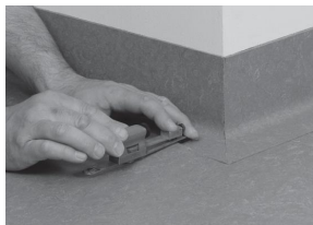
Cut out the floor cobertura that will be laid efectuados na parte superior do rodapé
